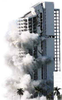
Destruction de bâtiments
