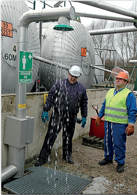
Le fonctionnement des équipements de protection collectifs est vérifié avant toute intervention
