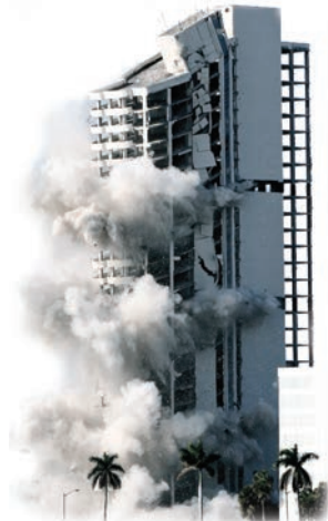
Destruction de bâtiment
