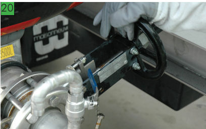
En fin de chargement, fermeture de la vanne.
