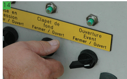
Ouverture de l'évent et du clapet de fond
