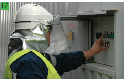
Mise en route de la pompe aspirante
